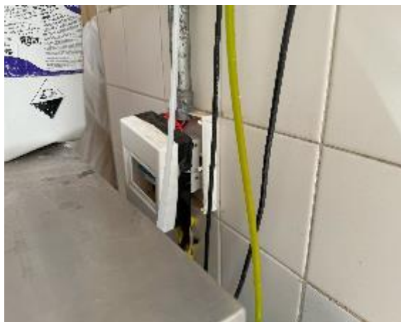
Instalação elétrica precária da lava-louças
