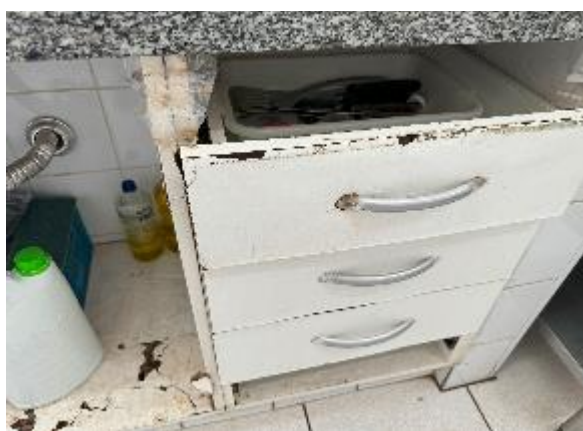
Marcenaria deteriorada por vazamento no sifão
