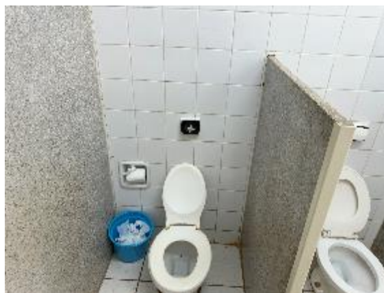
Cabine do banheiro sem sem proteção da válvula
