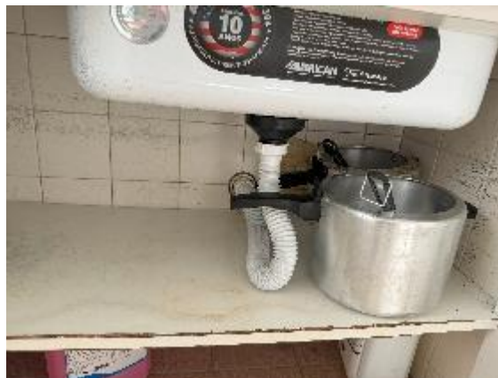
Vazamento no sifão da pia
