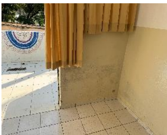
Parede de sala de aula com sinais de infiltração
