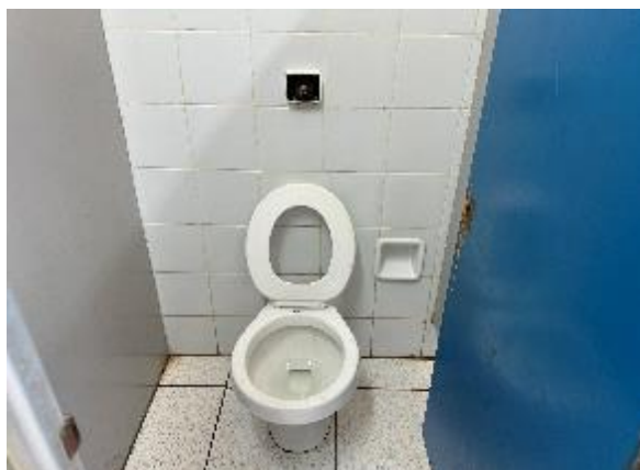
Cabine sem proteção da válvula
