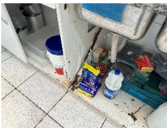
Vazamento no sifão da pia
